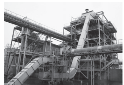
【発電プラント】
