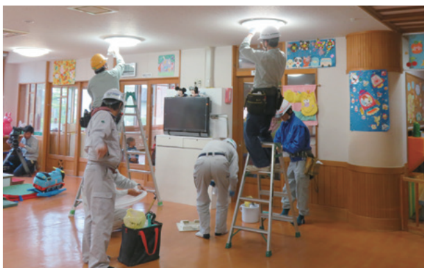
[電気設備の点検作業]
